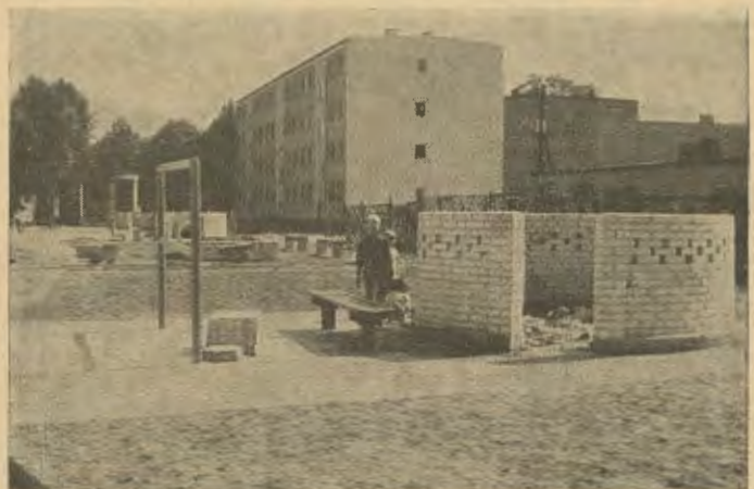
Blick auf den Hindenburgplatz von Westen, von der Bäckerstraßen-Rückseite. Das neue Haus steht direkt vorm Pfarrhaus, das abgerissen werden soll.
